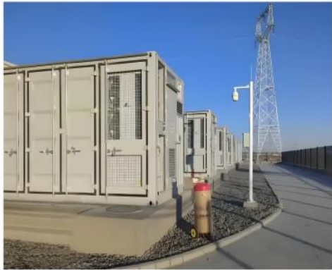
山东枣庄200MW/400MWh 独立储能
