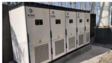
合肥瑞星机械工商业储能项目
