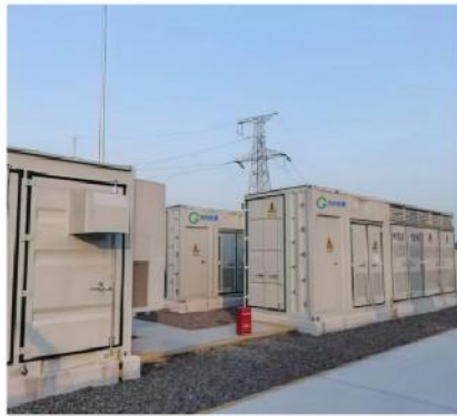
甘肃光伏工程配套30MW/60MWh 储能项目
