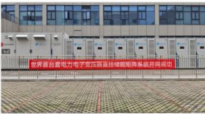
万国数据重庆水土数据中心10kV直挂储能电站
