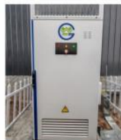
烟台奥星工商业储能项目
