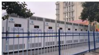
合肥通泽工商业储能项目
