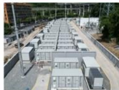
邯郸钢铁120MW/240MWh 工商业储能项目
