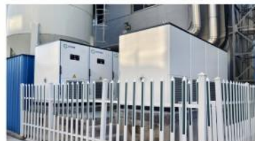
江苏宜兴工商业储能项目
