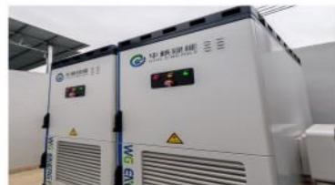
江门顶泰灯饰工商业储能项目
