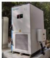
厦门海岛型微电网项目
