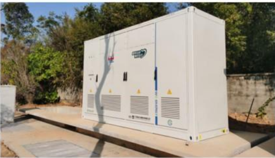
广东江门高速服务区光储直柔充电站
