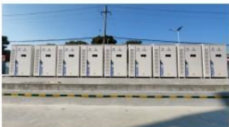
无锡格林美工商业储能项目
