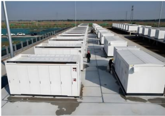
宁夏银川200MW/400MWh 独立储能
