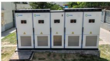
青海西宁机场综合智慧能源项目
