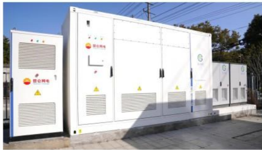
江苏昆山SST直挂超快混合充电站
