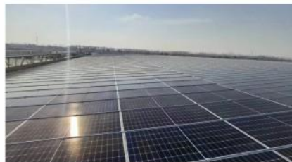
东风悦达起亚72MW光伏项目
