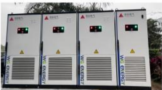
东莞友华工商业储能项目
