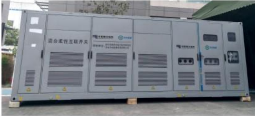
贵州黔南混合柔性互联开关项目
