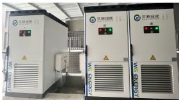
顺德恒昌工商业储能项目
